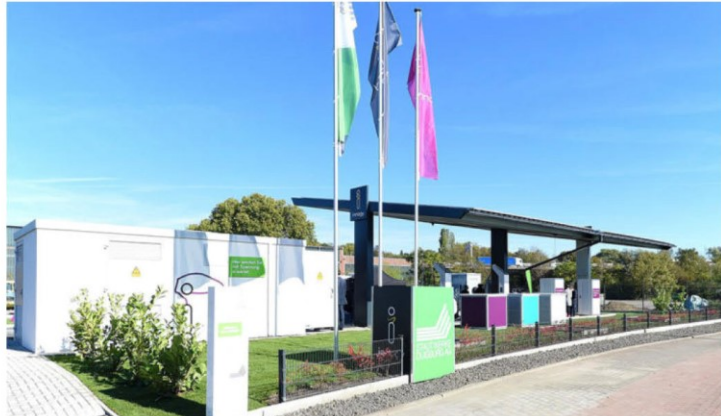
Kombi-Ladestation von Innogy in Duisburg mit integriertem Batteriespeicher (210 KW) für Plugin als ausbaufähiges Basismodell – noch ohne BWS, Dual Use und systemimmanentes gesteuertes Laden (s. M2G 2.0+, SCS-Hub-System)
