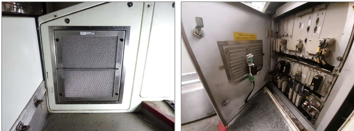
Abbildung 9: Belüftungsgitter und der geöffnete Elektronikschrank der Baureihe 481
