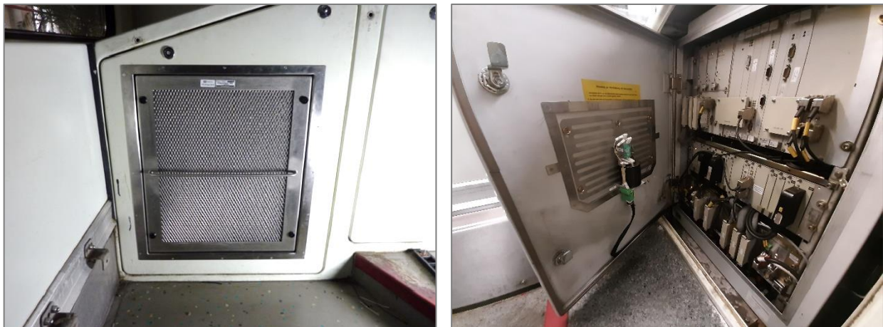
Abbildung 9: Belüftungsgitter und der geöffnete Elektronikschrank der Baureihe 481
