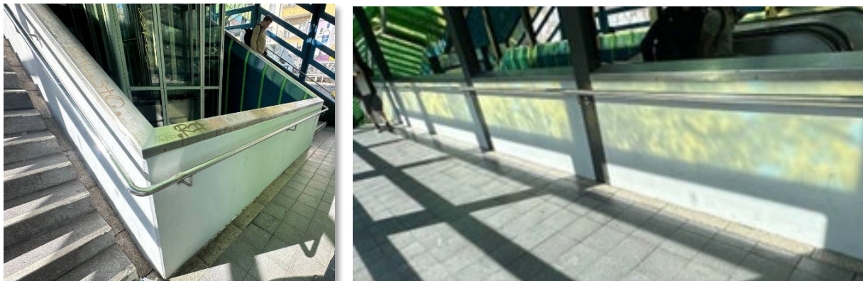
Abbildung 21a: Wandflächen Treppenabgänge Bf. Hermannstraße (vorher)
