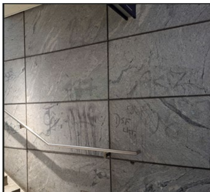
Abbildung 24a: Wandflächen Treppenabgänge Bf. Spandau (vorher)
