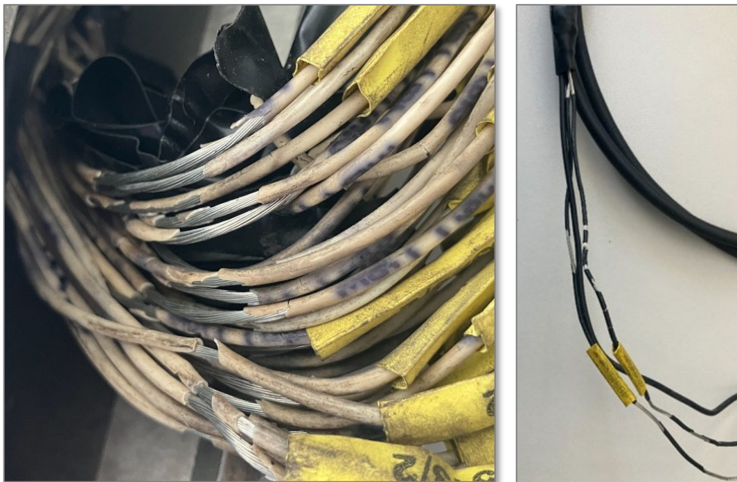
Abbildung 14: Isolationsschäden bei der Baureihe 481
