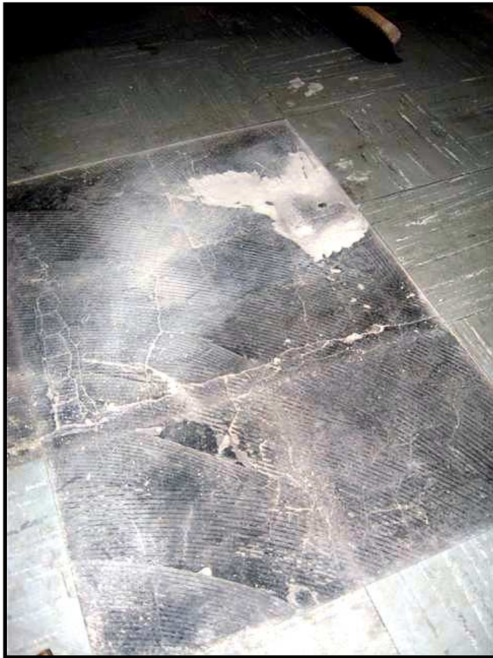
Foto 1: Asbesthaltige Flexplatten (P 13) und ebenfalls asbesthaltiger Bitumenkleber (P 12) auf dem Fußboden im Raum 102 im OG der Hallen. Im Bereich solcher schadhaften Stellen werden Asbestfasern freigesetzt.
