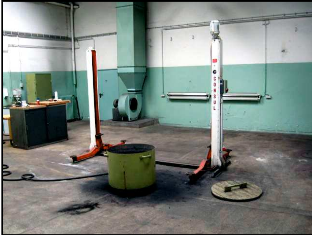
Foto 9: Werkstattbereich mit grünem, bleichromathaltigem Anstrich der Wände (P 1). Auch der Liegestaub in den betroffenen Bereichen (P 14) ist stark mit Bleichromat belastet.
