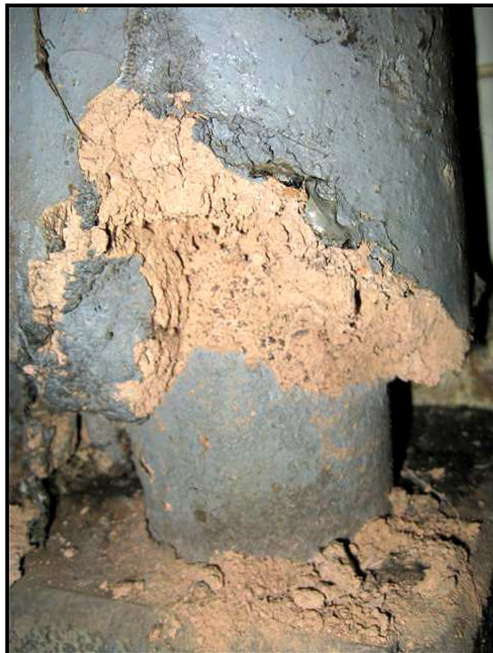
Foto 4: Schadhafte Rohrisolierung mit schwach gebundenem Asbest (P 2) im Raum 79 (Batterieraum) im EG der Hallen.
