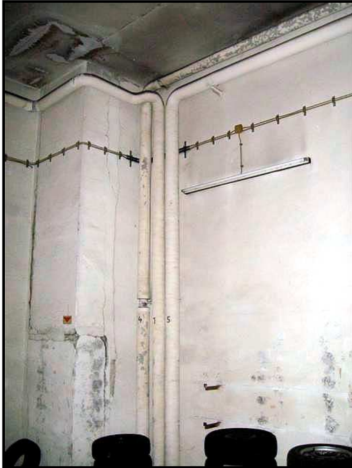
Foto 3: Heizleitungen mit Isolierung z.T. aus schwach gebundenem Asbest im Raum 81 im EG der Hallen (Werkstattbereich).
