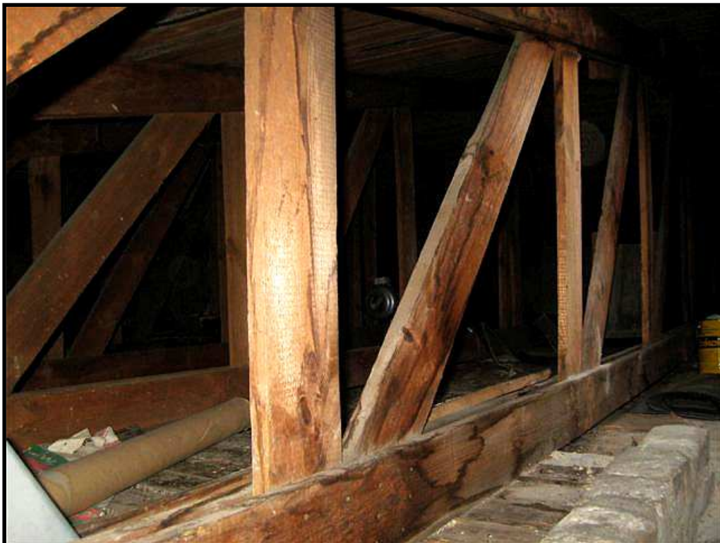
Foto 10: Dachgeschoss des Verwaltungsgebäudes mit PAK-belastetem Staub (P 11) aufgrund belasteter Dachpappe und Pechkleber.
