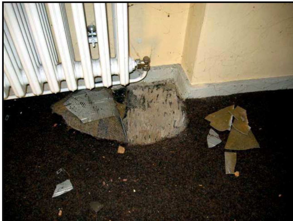
Foto 2: Asbesthaltige Flexplatten (P 9) und Bitumenkleber (P 10) und Teppichüberdeckung im ungenutzten Eckbereich (Teil Fuhrpark) des Verwaltungsgebäudes (EG, Raum S2).
