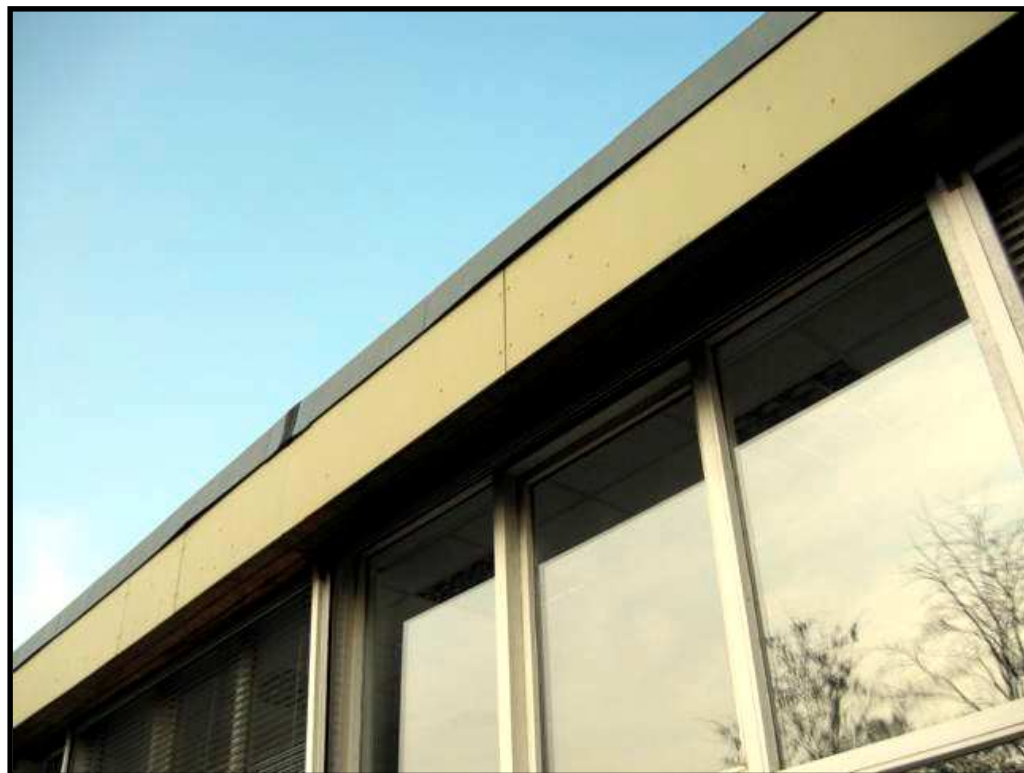
Foto 6: Attikaverkleidung aus Asbestzementplatten am Leitstand der Hallen.
